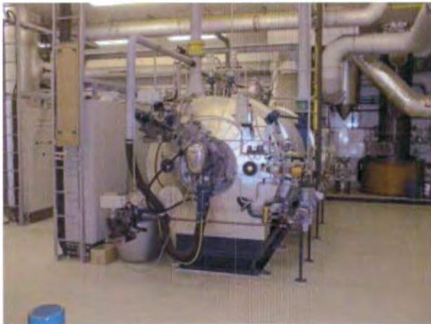
Figuur 6.7 : Vloeistofoven met rookgasreinigingsinstallatie
