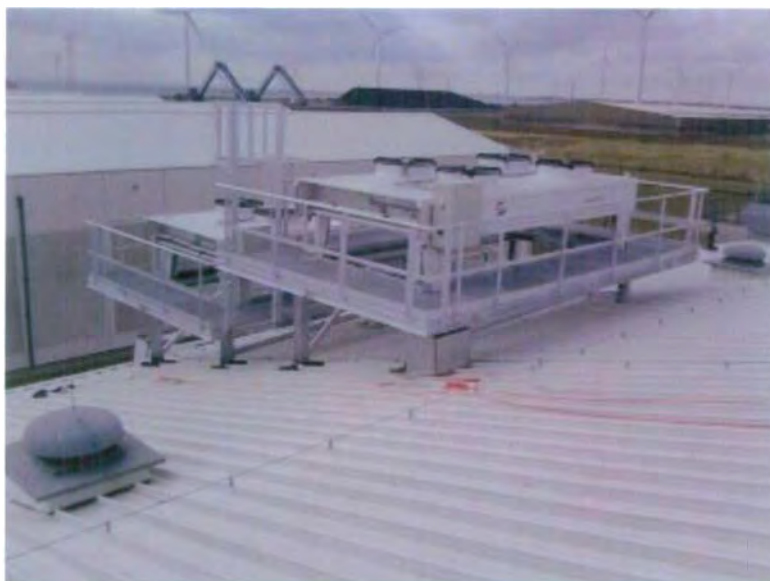
Figuur 6.19: Condensors van de koelmachines
