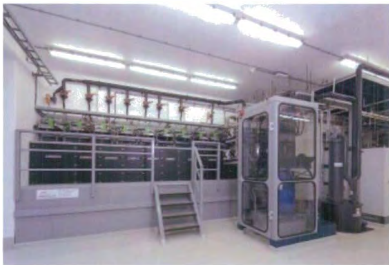
Figuur 6.5: Chemicaliën doseerstation
