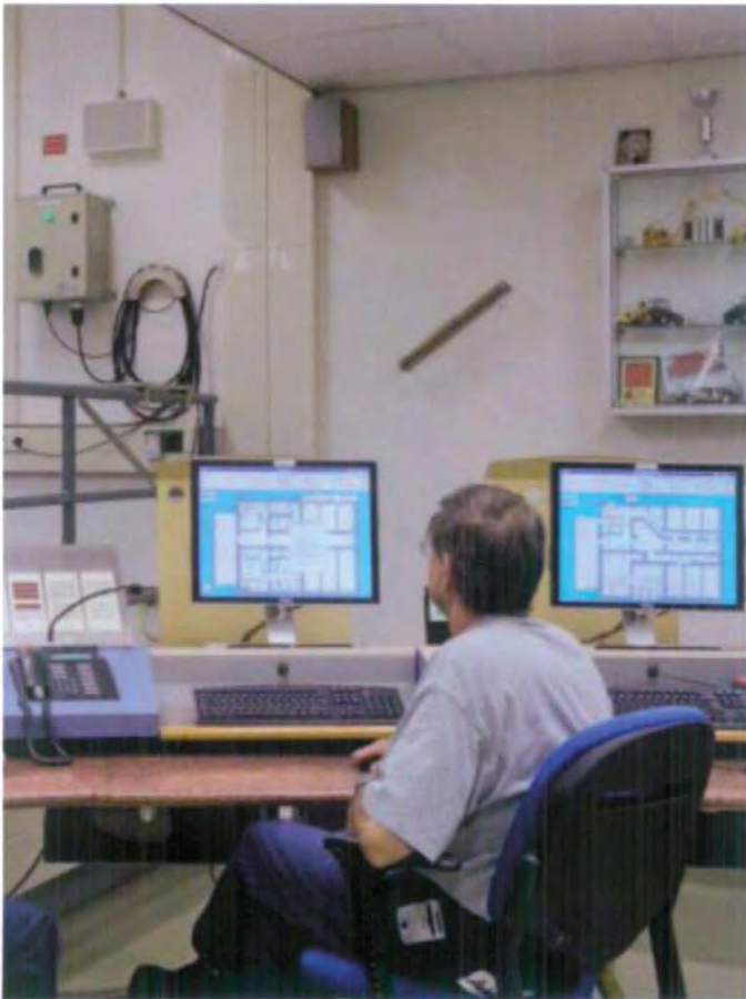
Figuur 8.13 : Controlekamer van het HABOG
